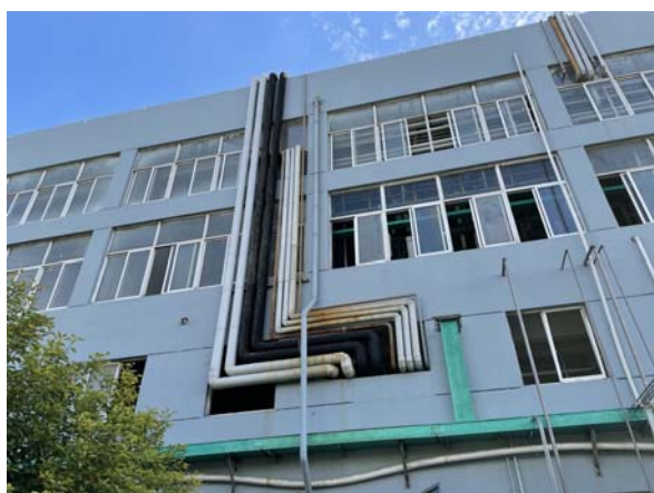
车间管线照片
