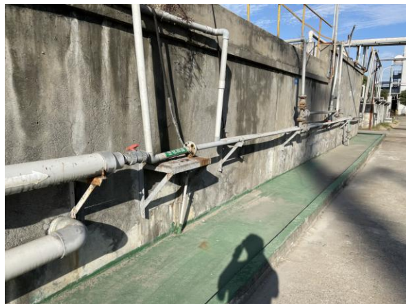
污水站管线照片
